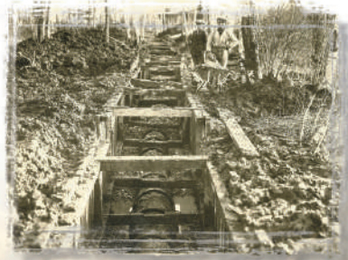
Construction de l'aqueduc Le guide d'eau en construction en 1922. Au premier plan, l'usine de la St. Maurice Paper. (Source: Société d'histoire de Cap-de-la-Madeleine)
