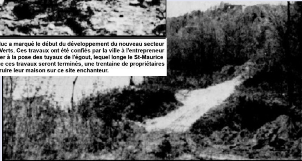
UN NOUVEAU SECTEUR domiciliaire de Trois-Rivières commence à prendre forme avec les travaux d'égout et d'aqueduc qui viennent de commencer aux Plateaux Verts. La photo nous fait voir une partie du chemin que la ville a ouvert dans le secteur situé aux limites nord-ouest de la ville, à proximité du St-Maurice. Il touchera les extrémités du secteur St-Jean-Baptiste-de-La-Salle.
