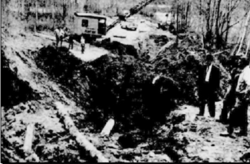
LA CONSTRUCTION de l'égout et de l'aqueduc a marqué le début du développement du nouveau secteur domiciliaire de Trois-Rivières Les Plateaux Verts. Ces travaux ont été confiés par la ville à l'entrepreneur Gaston Bourassa. La photo nous fait assister à la pose des tuyaux de l'égout, lequel longe le St-Maurice avant de se déverser dans la rivière. Lorsque ces travaux seront terminés, une trentaine de propriétaires ont l'intention de construire leur maison sur ce site enchanteur.
